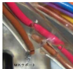
被害痕跡の一例
