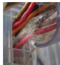
被害痕跡の一例
